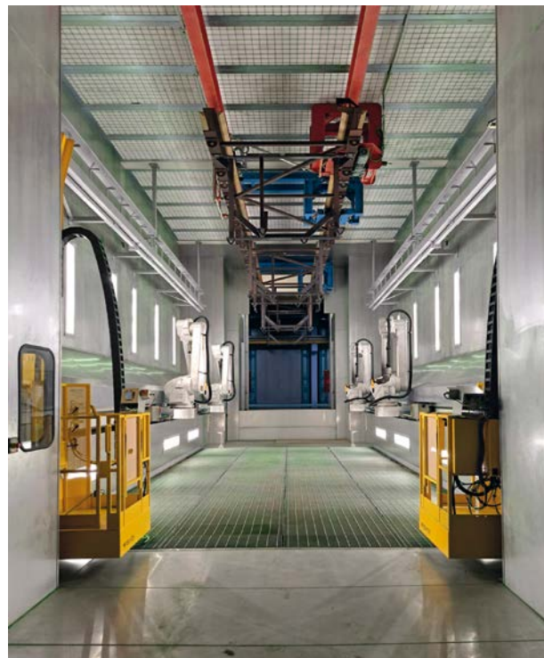
Pohled na instalované roboty v kabině
