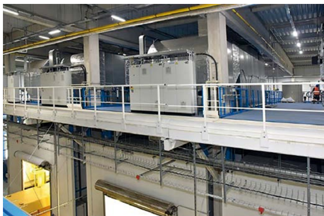
Umístění vzduchotechnických jednotek nad kabinou
