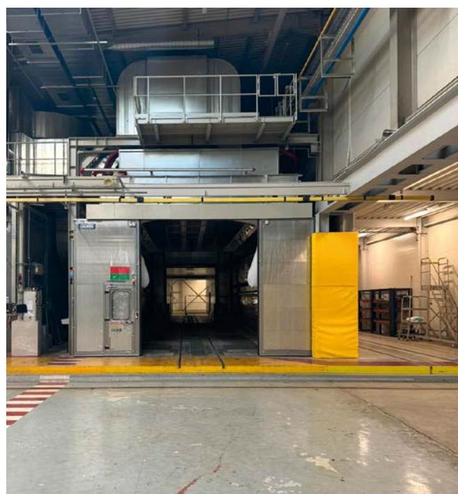
Pohled na novou instalaci (2024)
