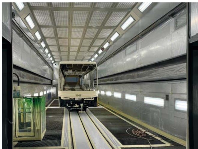
Interiér nové robotické kabiny (2024)
