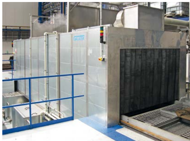
Průjezdný odmašťovací stroj, CZ LOKO Česká Třebová
