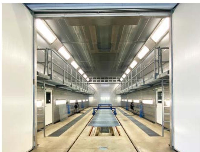
Kabina odmaštění, SOR Libchavy
