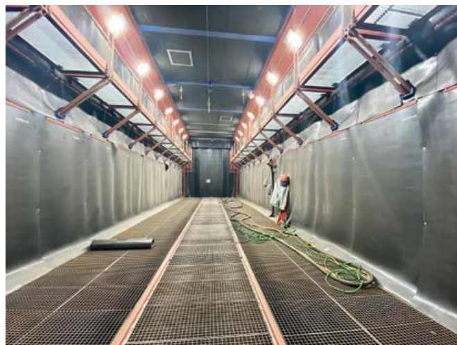
Kabina ručního tryskání, ŠKODA EKOVA Ostrava
